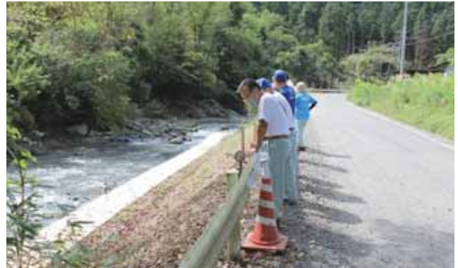
河川の法面が崩落した富岡神流線・戦場地区（秋畑）
