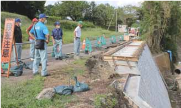
法面が崩落した白倉川（白倉平石地区）
