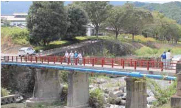
添架された配水管が流された裏門橋（小幡）
