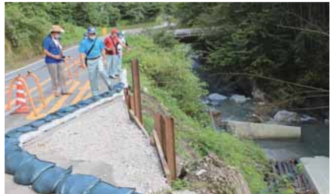
土砂崩れにより路面が崩壊した富岡神流線・上来波付近（秋畑）
