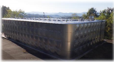
白倉高区配水池（上野）
