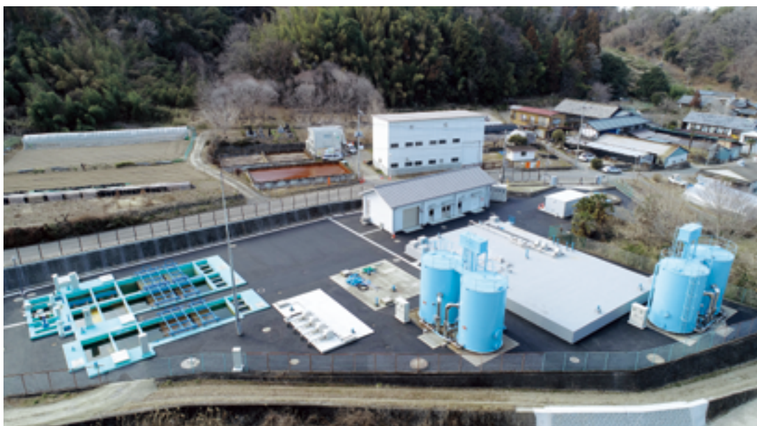
白倉第一浄水場
