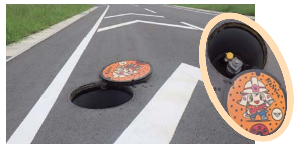
甘楽第一産業団地（金井）の配水管布設工事で設置した消火栓
